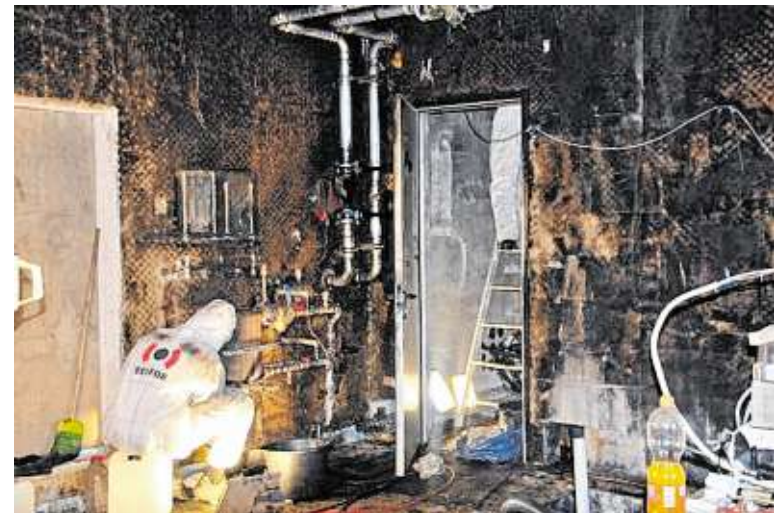
Im Technikraum riecht es verkohlt, die Wände sind teilweise noch rabenschwarz. Arbeiter in Schutzanzügen rücken dem Ruß mit Chemie zu Leibe und reinigen, was ansonsten keinen Schaden genommen hat.
